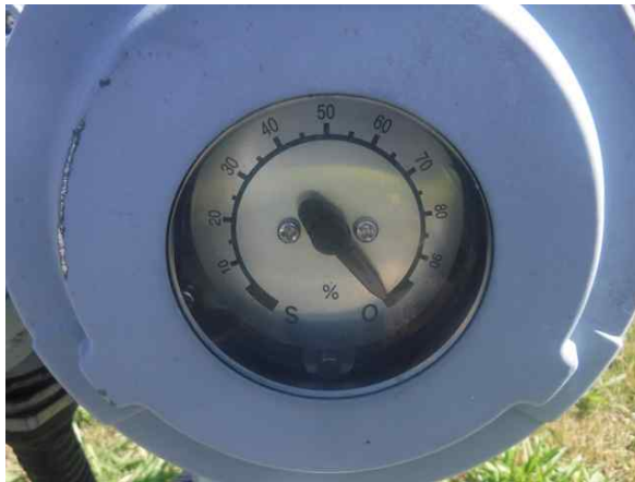
[전동밸브 : 개도계 상태양호]
