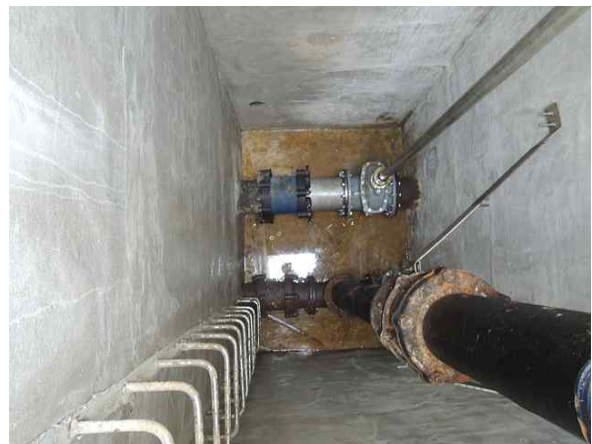
[밸브실 내부 전경]
