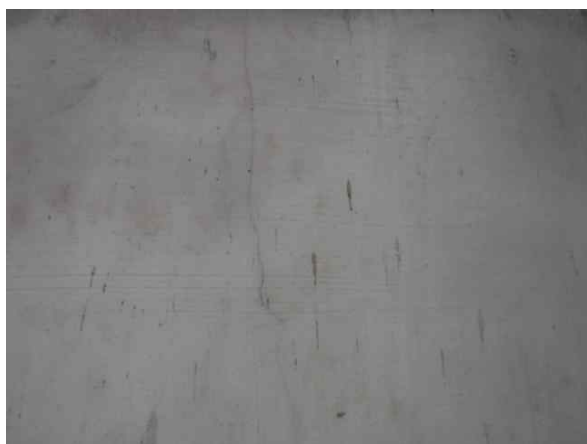
[1호지 유입밸브실 : 균열]
