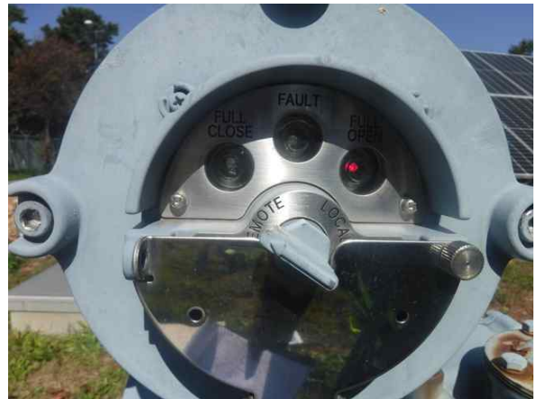
[전동밸브 : 작동 상태양호]
