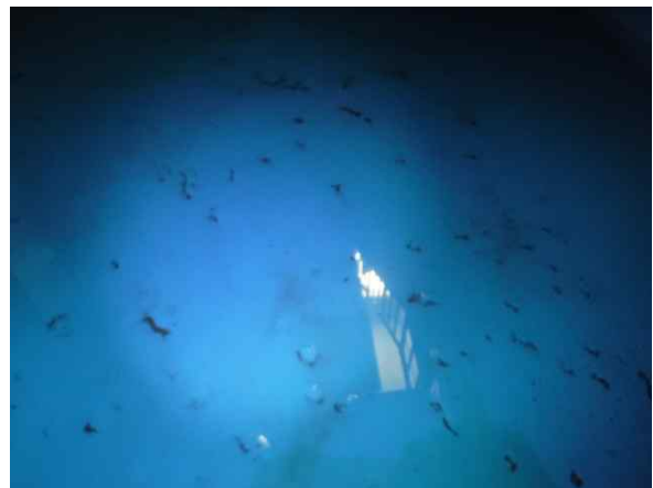
[배수지 1호지 바닥슬래브 : 기포]
